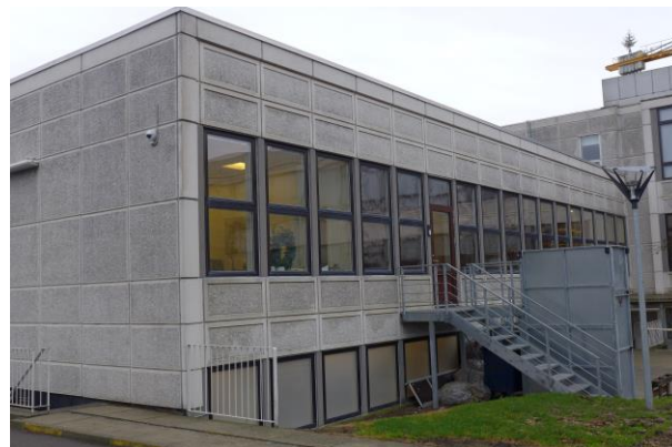
Eftersynshallens nord-vesthjørne. Facaden mod gården åbner sig mod gårdrummet (oprindelig grøn have?). Betonelementer mod haven er samme type som på for- og mellembygningen.
